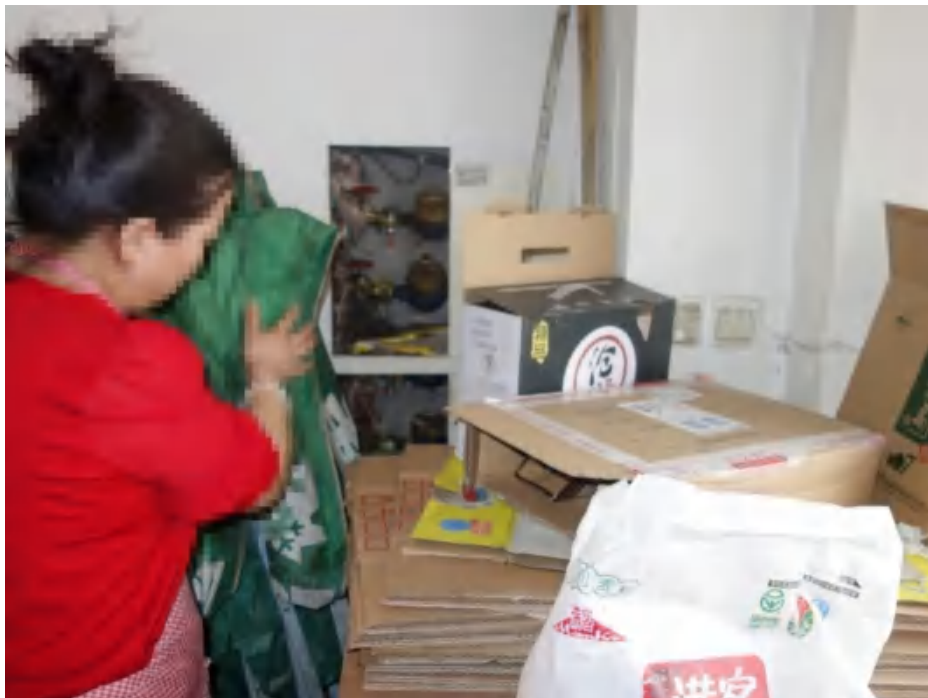
用户水表已出户，但位于一楼商铺内
