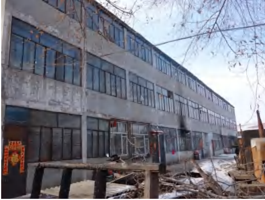
楼梯间无供热
