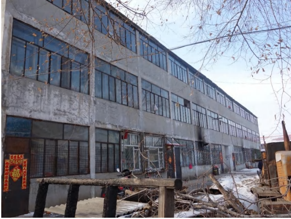
楼梯间无供热
