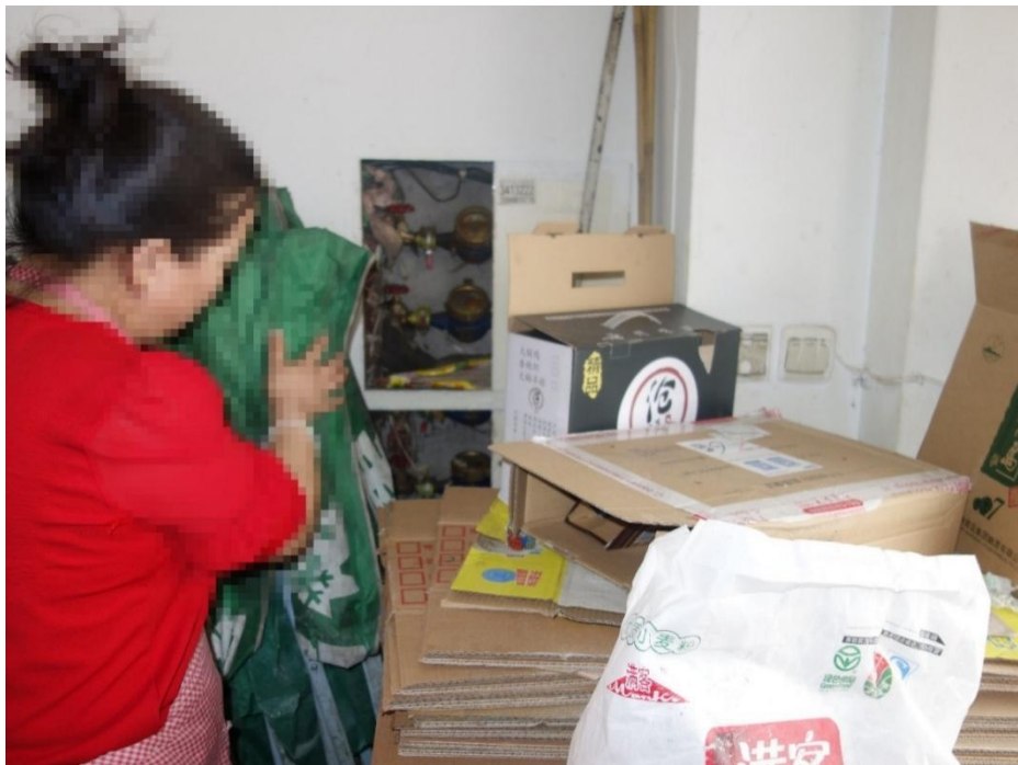
用户水表已出户，但位于一楼商铺内
